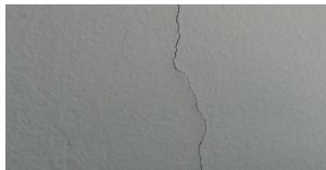
Terremoto, il Blocco Studentesco chiede chiarimenti sulle crepe presenti in alcune scuole FOTO
